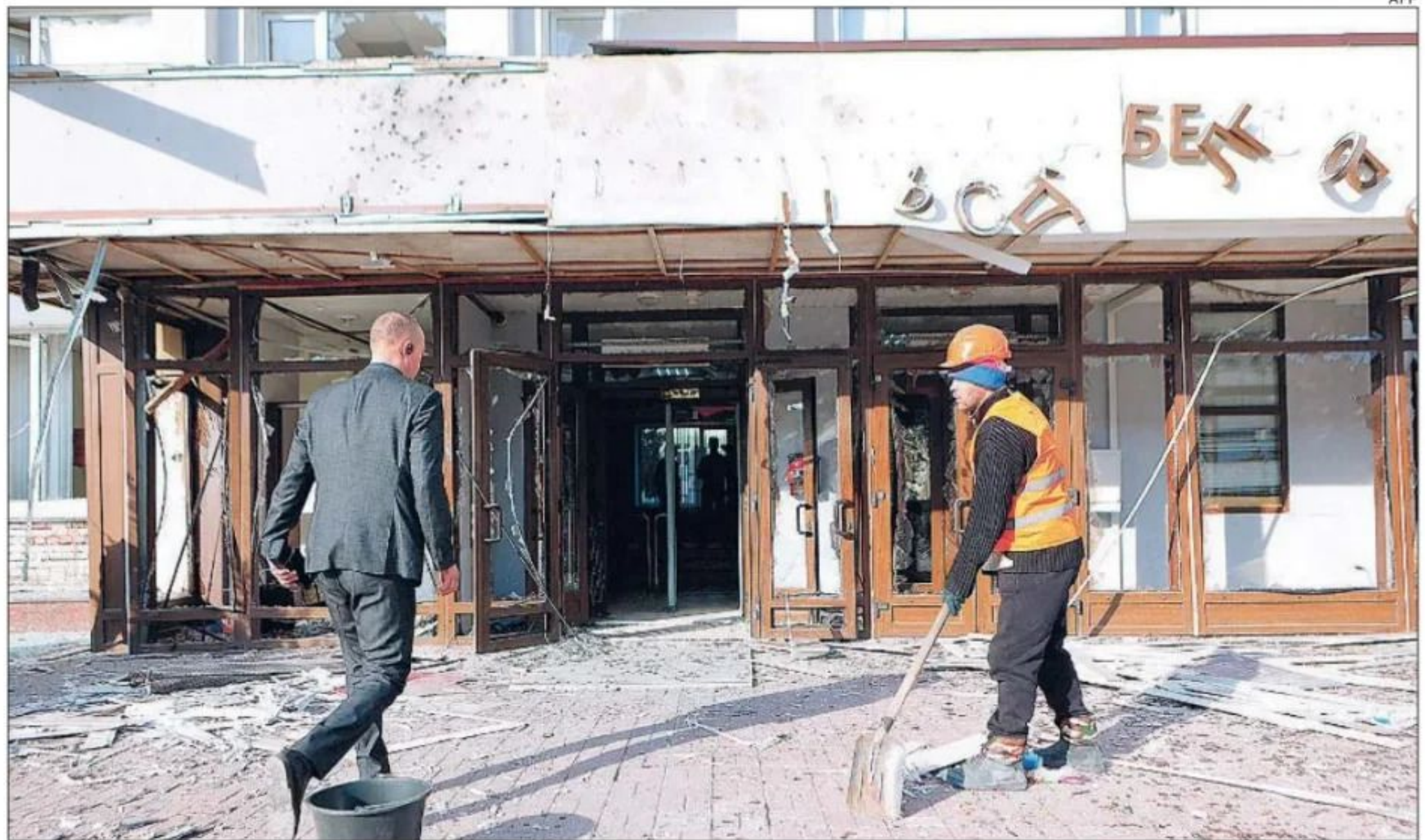
Un edificio dañado con el ataque simultáneo de las unidades rusas de resistencia en Belgorod
